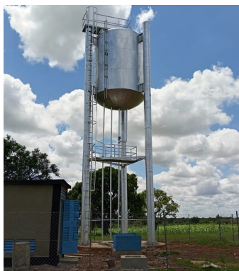
Château d'eau et local technique, système d'AEP de Youngou, 2026.
